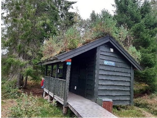
Toalettbygg. Eksisterende muldo er gammalt og det er behov for å oppgradere til nytt med større kapasitet.
