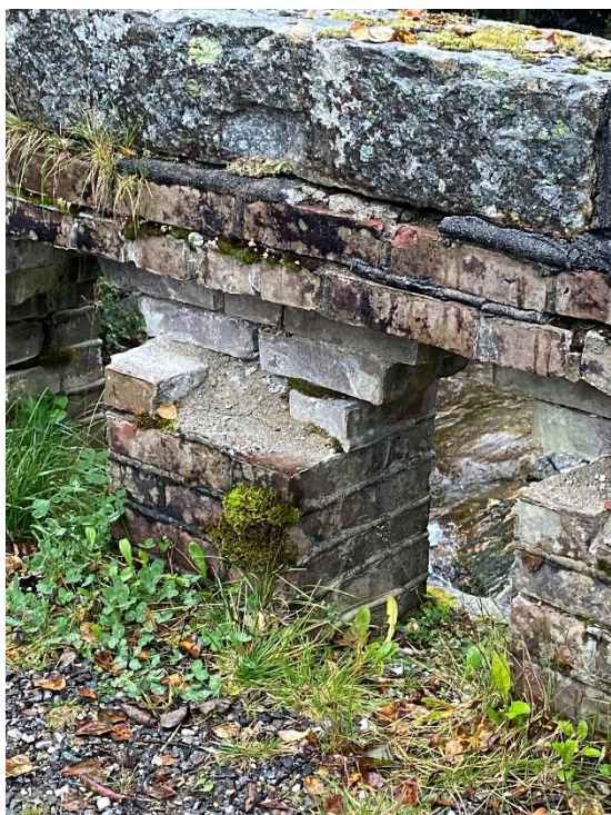
Skader på nedste brua
